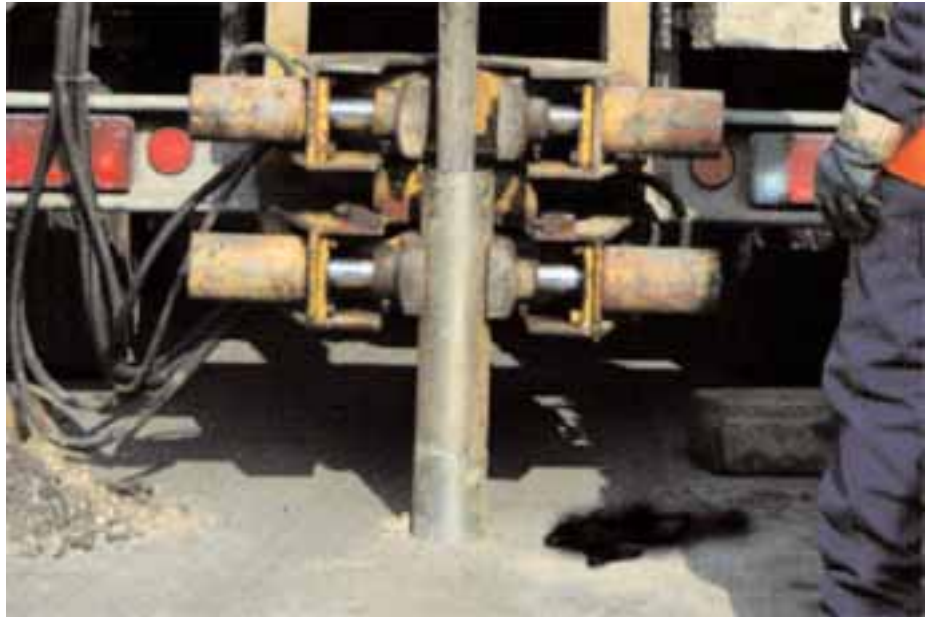
Figura 7.6 - La scarsa manutenzione della sonda può provocare la perdita di olio dai circuiti idraulici che può compromettere il risultato finale del campionamento
