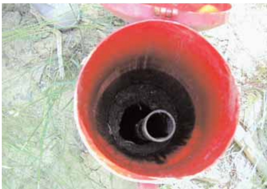
Figura 3.23 - Effetti di una cattiva sigillatura superficiale: la bentonite scollata dalla boccapozzo ha creato un vuoto attraverso il quale può infiltrarsi acqua piovana o altre sostanze
