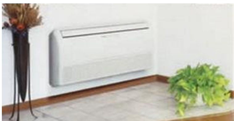
Figura 5.6 - Climatizzazione split: Unità interna a livello del pavimento (Fonte: UNEP Ozone Secretariat, Fact Sheets 8, 2015)
